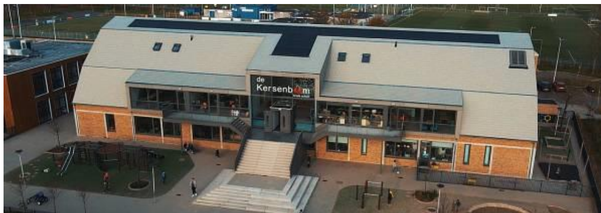
Figuur 1 Het dak van brede school De Kersenboom. Het gebouw is in 2020 opgeleverd.
